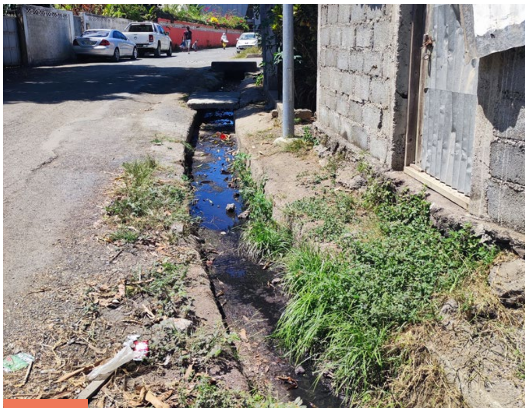
Intrusion des eaux marines dans le réseau d'eaux pluviales à Petite-Terre, Mayotte - Source : Geoffrey Haraca
