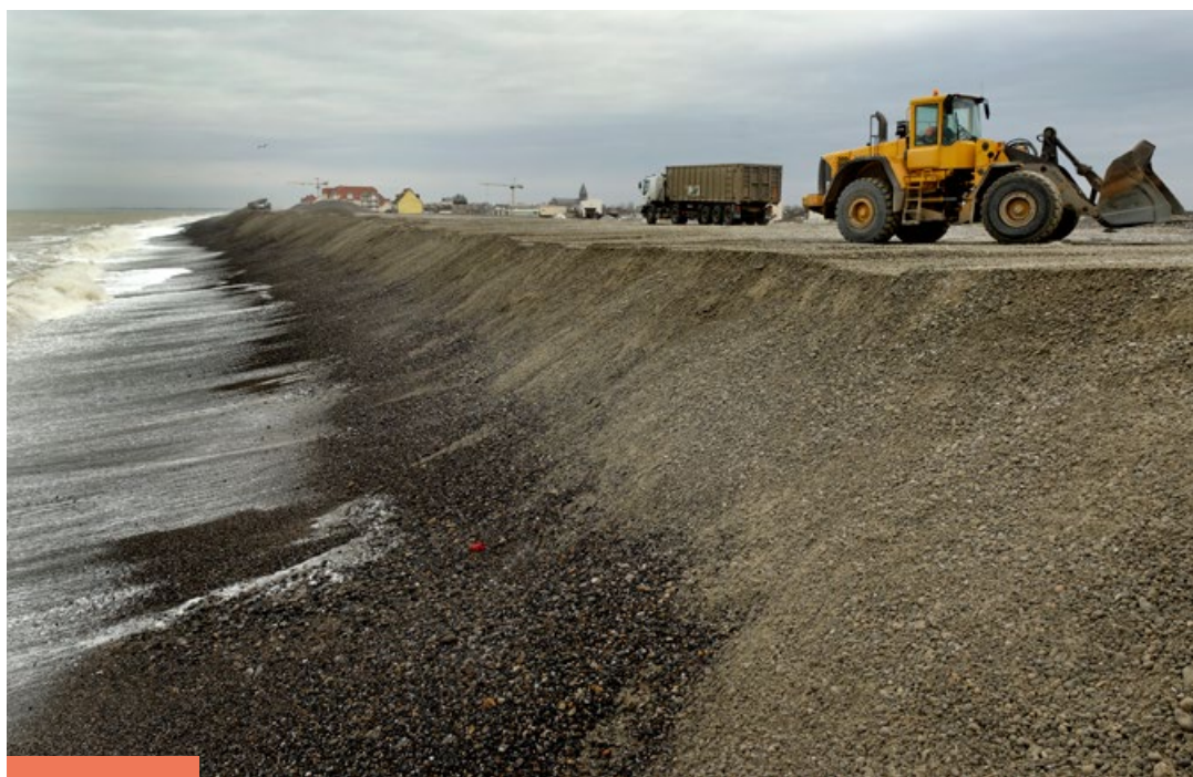
Cordon de galets de Cayeux-sur-Mer (80) : construction d'épis et apport artificiel de galets pour lutter contre l'érosion littorale - Source : Laurent Mignaux/Terra
