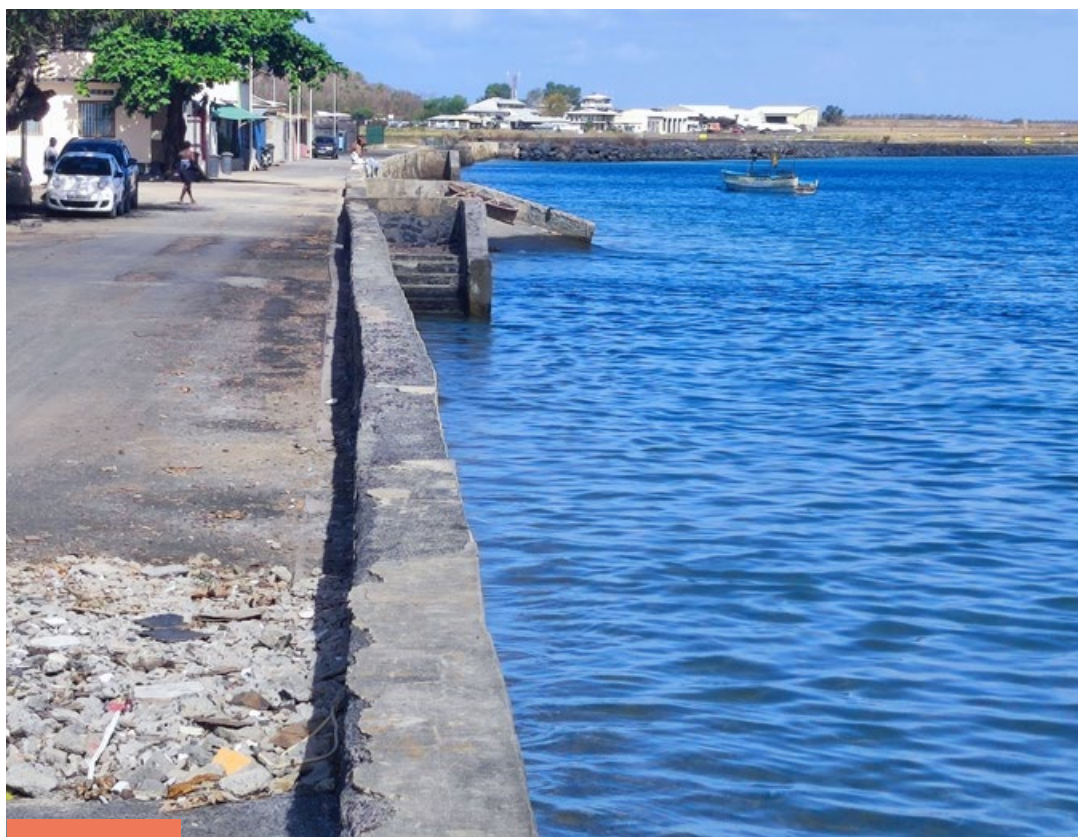
Affaissement de la voirie au droit du mur de soutènement à Petite-Terre, Mayotte - Source : Geoffrey Haraca
